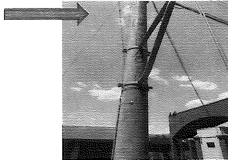
Ilustración 6. Condominio Avicennia Norte. Poste de ingreso.
